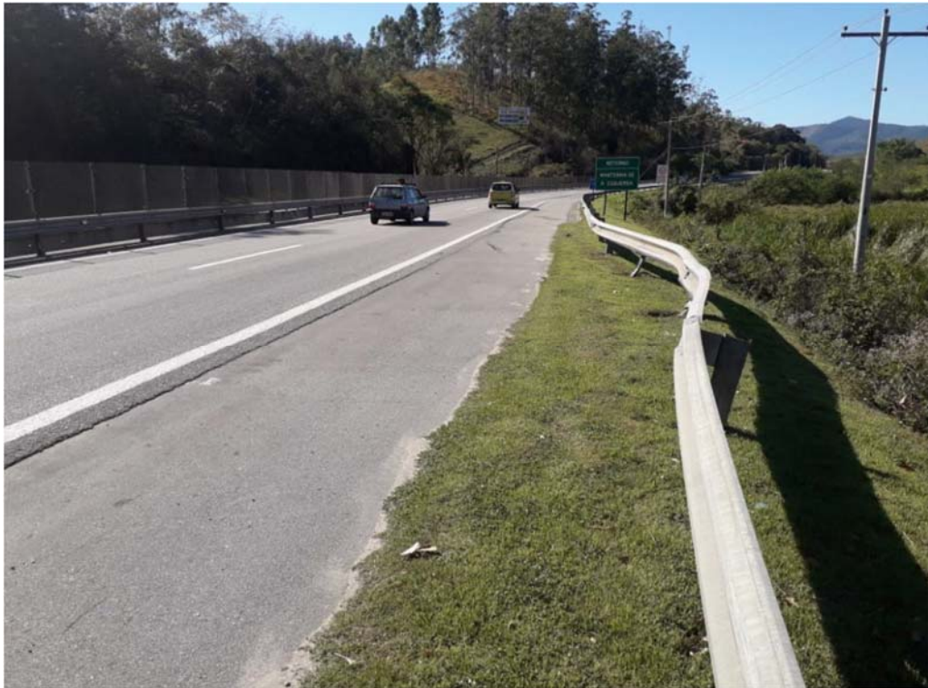
FOTO 09 - Dispositivo de Segurança - Km 06+900 Norte - F1.
