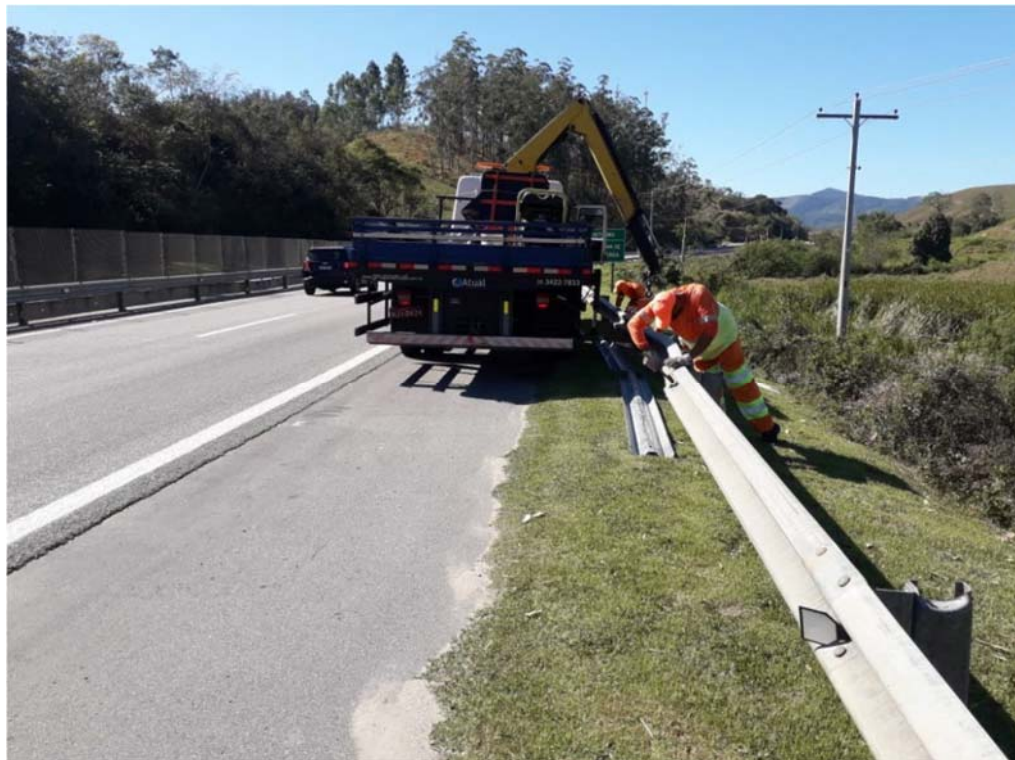
FOTO 10 - Dispositivo de Segurança - Km 06+900 Norte - F2.
