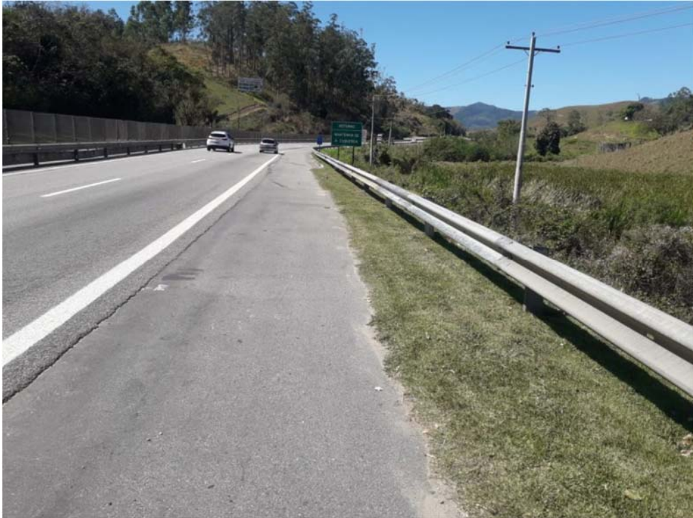
FOTO 11 - Dispositivo de Segurança - Km 06+900 Norte - F3
