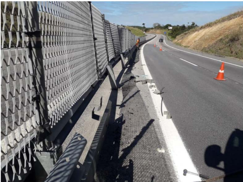
FOTO 13 - Dispositivo de Segurança - Km 41+700 Norte - F1
