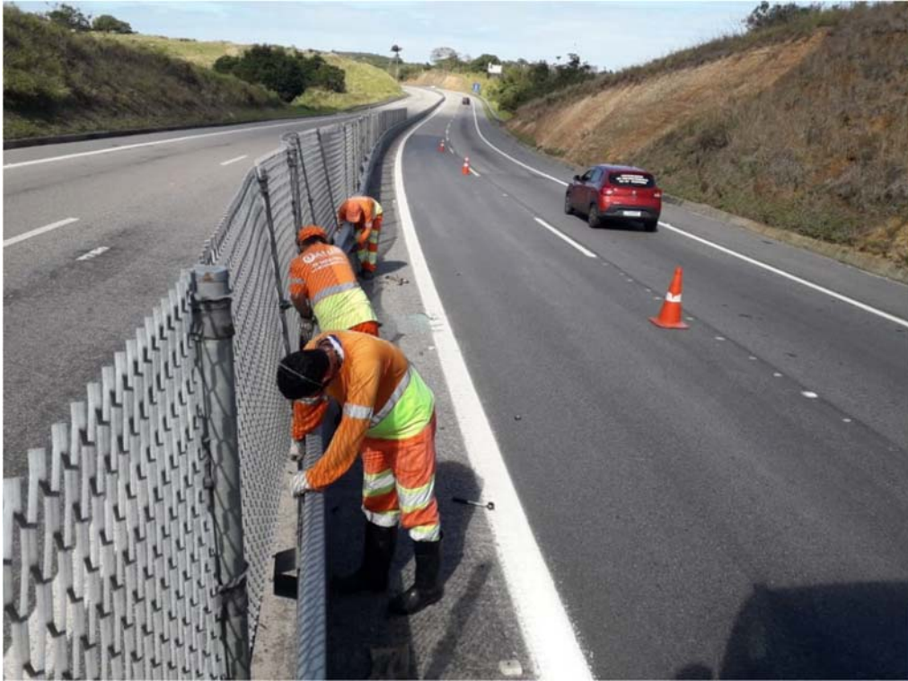
FOTO 14 - Dispositivo de Segurança - Km 41+700 Norte F2
